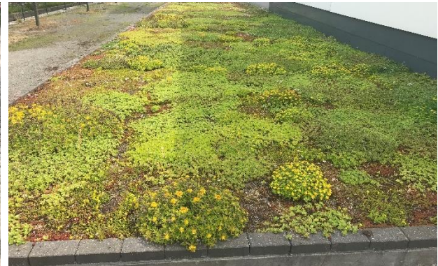
Figur 57 Sedumdekke på fordrøyningsanlegg.
