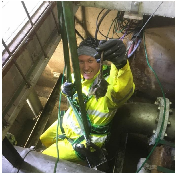
Figur 31 Rottefangst i Auglandsbukta pumpestasjon.
