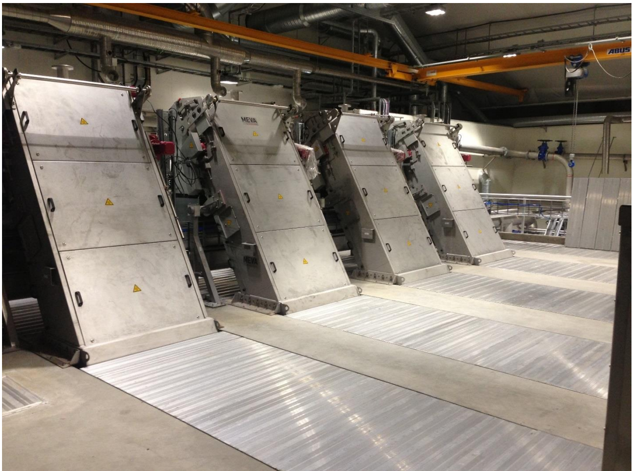
Figur 15 Odderøya renseanlegg – nye innløpsrister.
